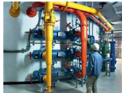
Vista interna de la casa de fuerza de Guangzhou
