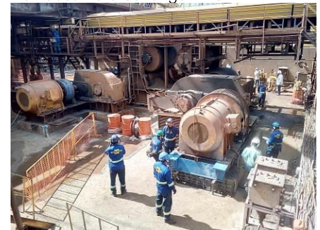
Während der Prüfung der Voith Anfahrkomponenten
