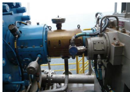
Niederdruckverdichter, Kupplung mit Verschalung und Getriebe des Strangs
