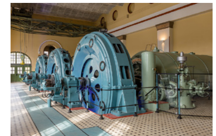
↑ Der Maschinenraum im Kraftwerk Tinfos II. Die drei Generatoren aus dem Jahr 1912 sind heute nicht mehr in Betrieb.
