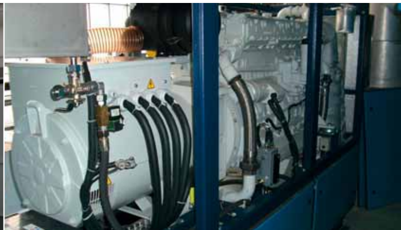
Abb. 2 und 3: Fast 500 MWh Strom produziert das Blockheizkraftwerk im deutschen Düren pro Jahr (oben). Zudem wurde der Erdgasverbrauch durch besser isolierte Rohrleitungen gesenkt (unten).
